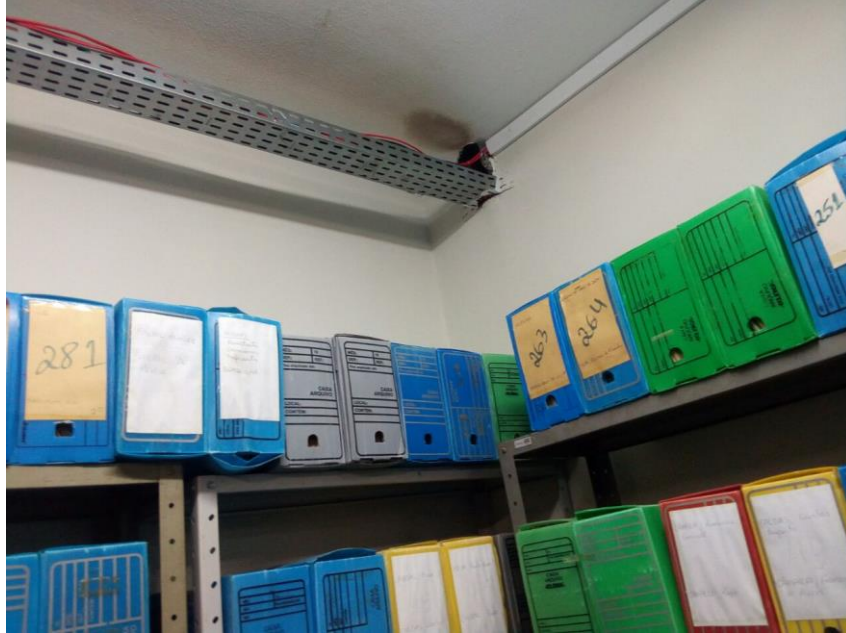
Figura 6 – Caixas com fotografias próximas às instalações elétricas
